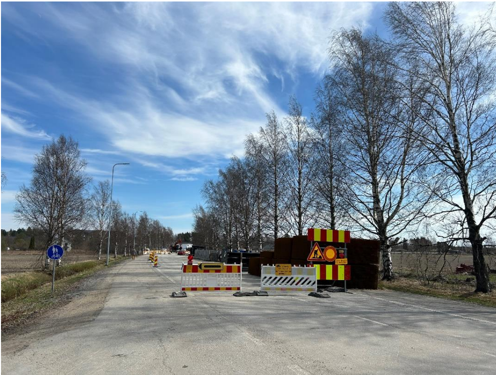
Kuva 5. Nybrontien koivurivi sekä käynnissä oleva Skarpängintien ja siihen liittyvän alikulun työmaa-alueita kuvattuna huhtikuussa 2024.
